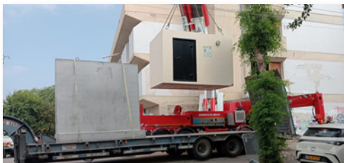
הצבת מיגונויות ברחבי העיר באזורים שזקוקים לתגבור, כחלק מהיערכות שוטפת לביטחון התושבים בחירום - בשיתוף פיקוד העורף
